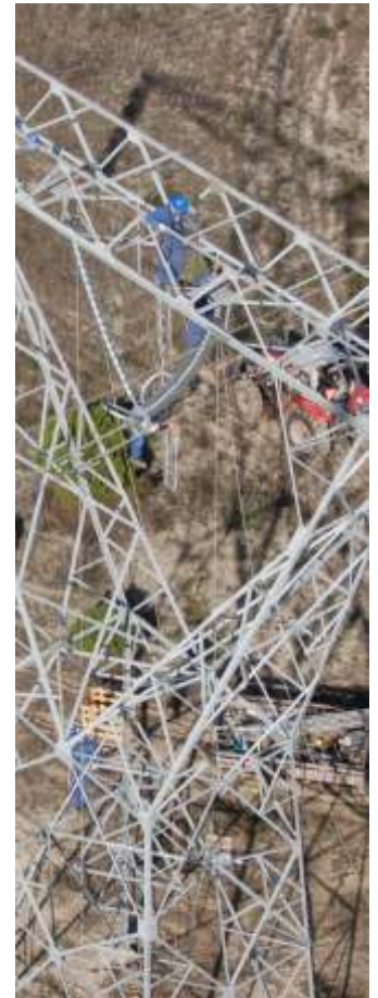
Figura 1 - la sustitución de las cadenas de aisladores en una línea de 400kV
